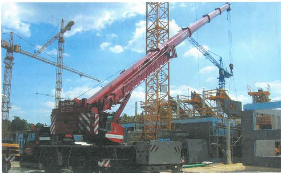
Der SCHOLPP Autokran HK 50 sorgte beim Neubau der Arena an der Schleyer-Halle für ein präzises Einheben der Fassadenelemente.
