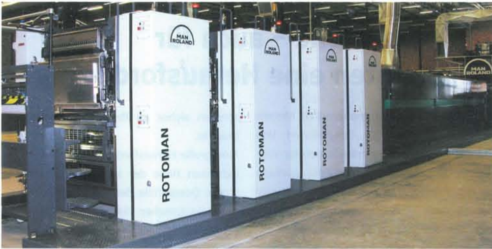
Bild links: Für die Installation der MAN Rotoman standen lediglich vier, für die der MAN Lithoman sechs Wochen zur Verfügung.
